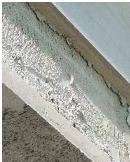
Ejemplo de la zona a consolidar ▲
